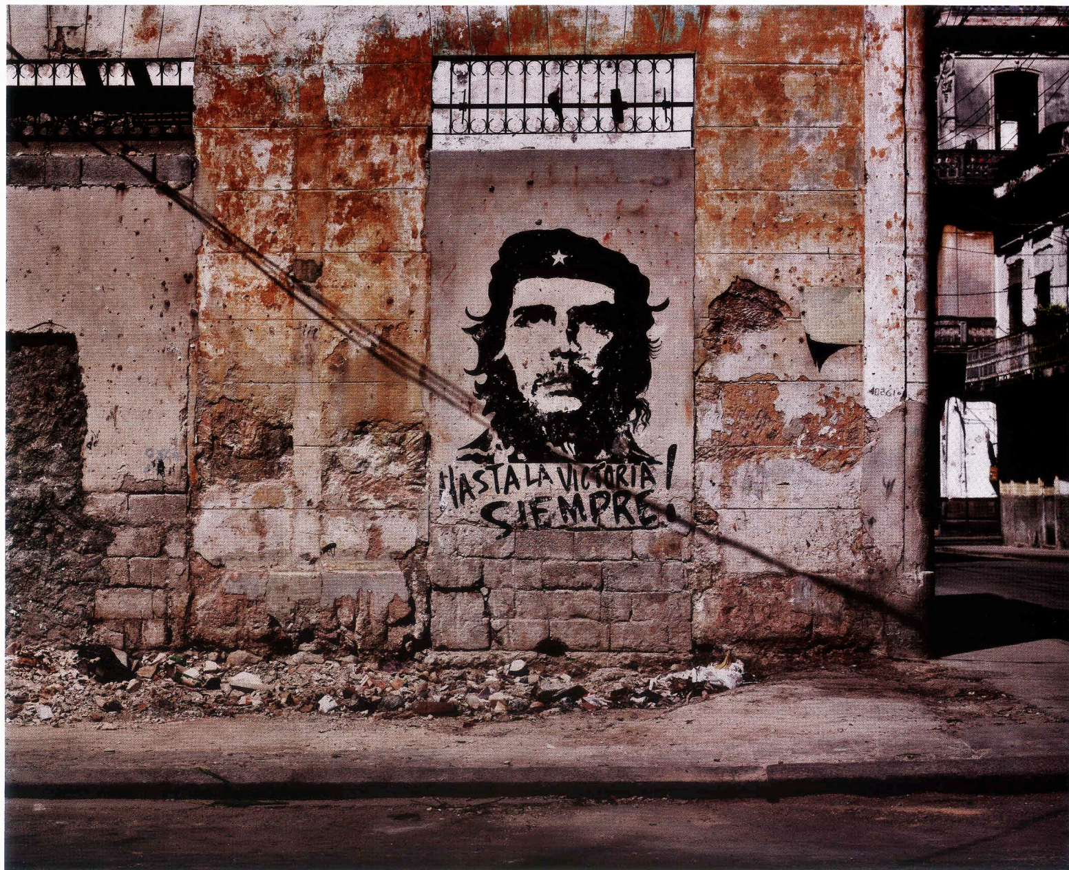
Die Revolution frisst an der Bausubstanz: Guevara-Graffito an einem abgewrackten Straßenzug.
